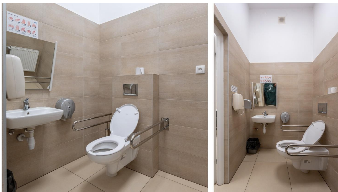
Zdjęcie 13 Widok na toaletę na pierwszym piętrze, wejście do toalety na końcu korytarza jest nieoznakowane.
